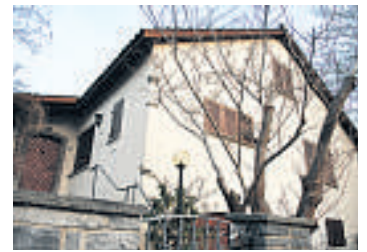
Sanierungsbedürftig: Ältere Häuser.
